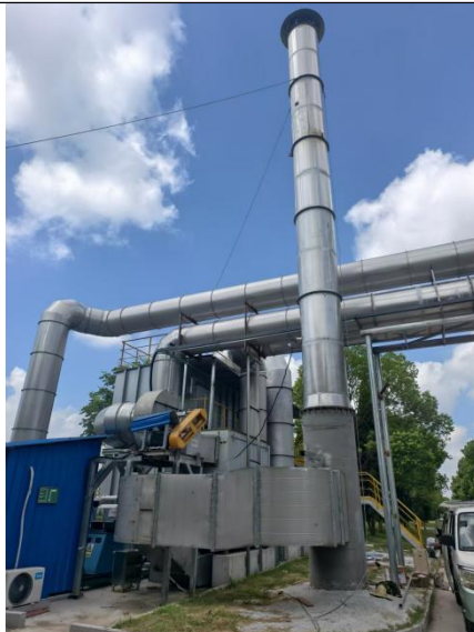
沸石转轮+RTO 蓄热式燃烧炉
