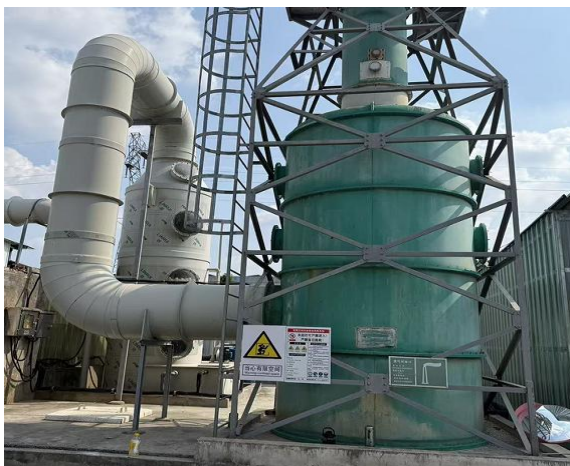
二级碱液喷淋塔
