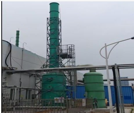
二级碱喷淋塔
