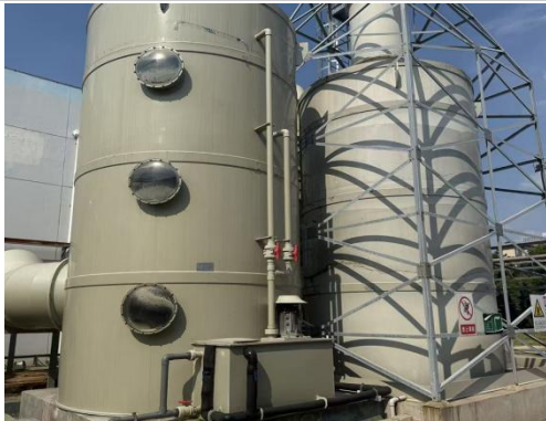
水喷淋+碱喷淋塔
