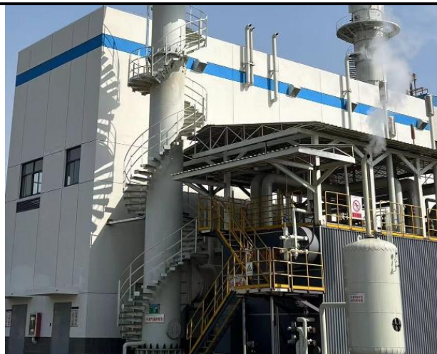
本项目生产设施
