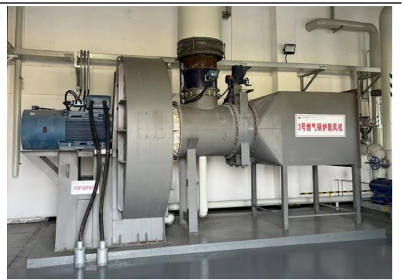
本项目生产设施
