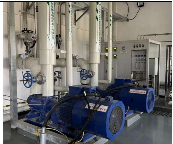
本项目生产设施
