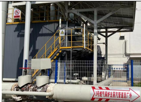
本项目生产设施
