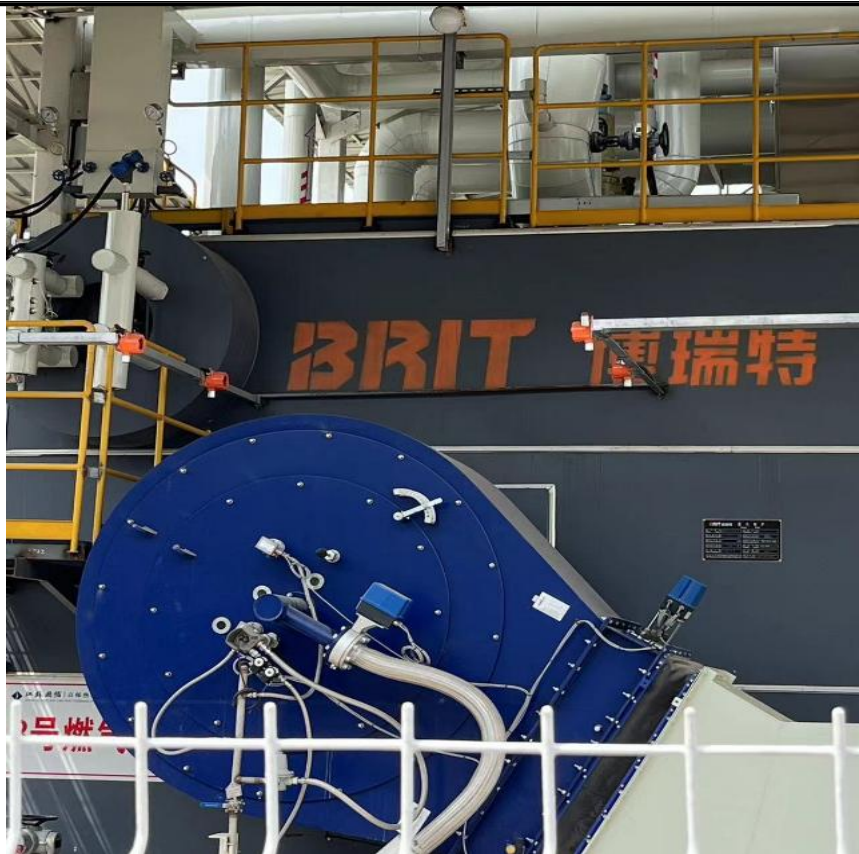
低氮燃烧装置
