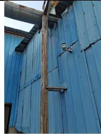
危废库外部摄像头
