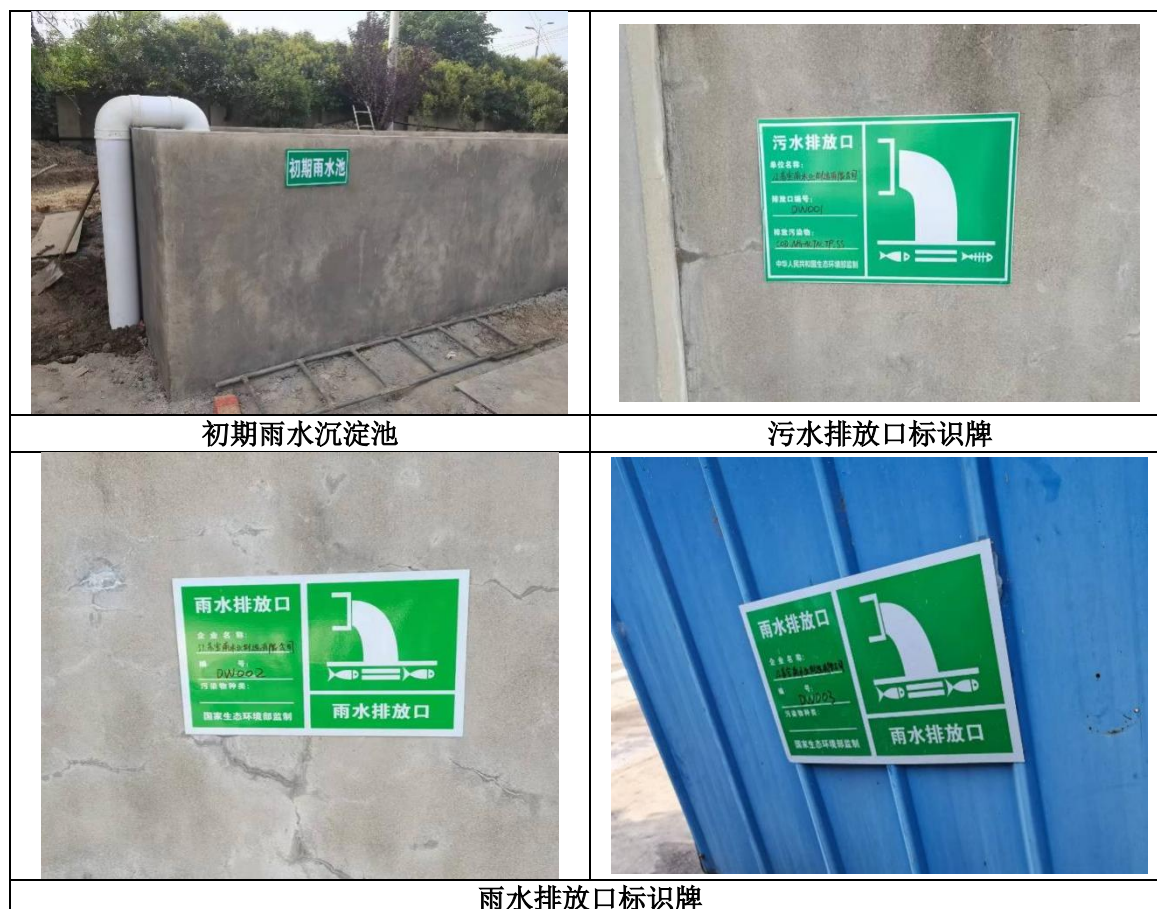
图 4-2 废水处理设施及排放口标识牌
